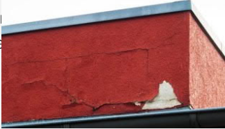
Südseite einer Hauswand mit Hitzeschaden (Foto: K.PLAN)
